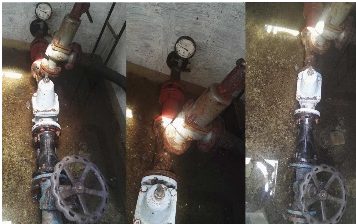
Zdjęcia wnętrza komory reduktora
